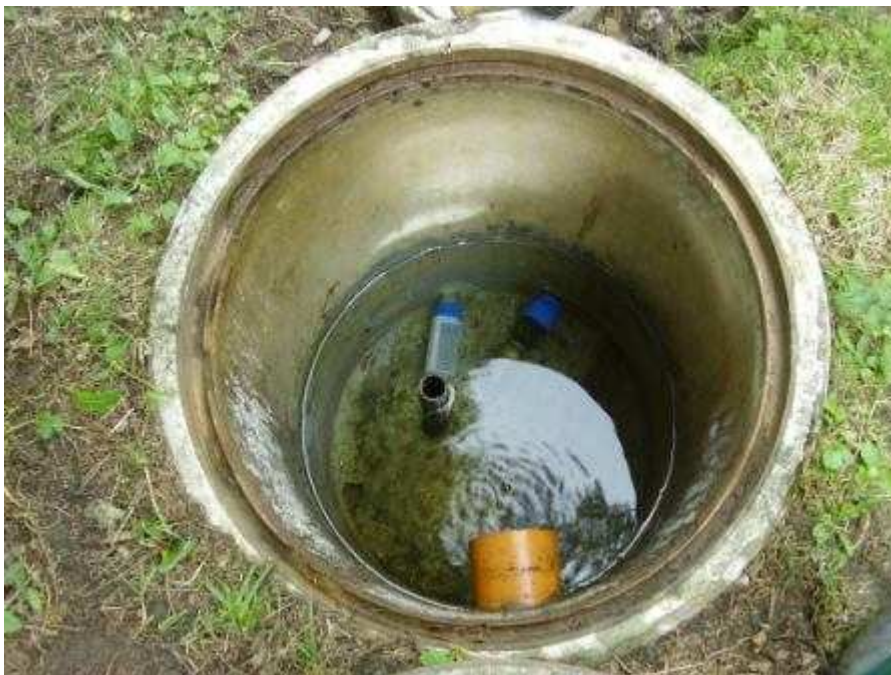
Der Fassungsschacht war zu tief in der Erde, somit konnte Oberflächenwasser eindringen!
