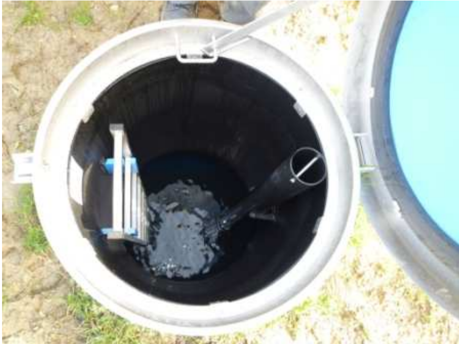
Ein Blick in das mit Wasser gefüllte Reservoir...
